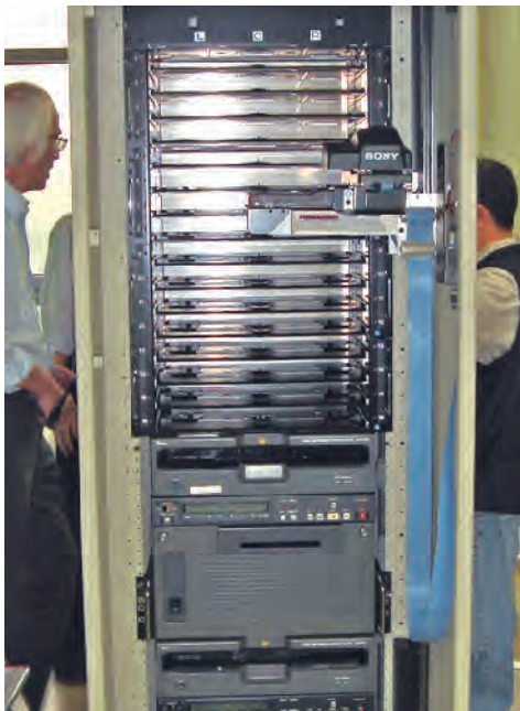
VERA2000が組み込まれた装置
